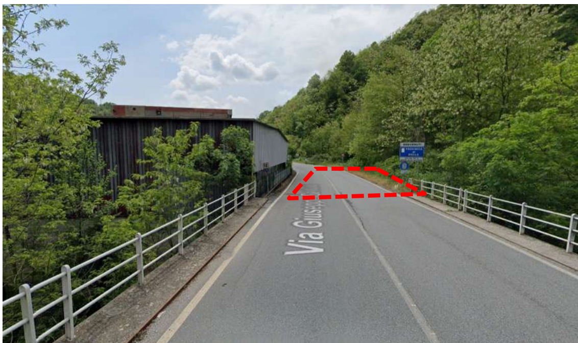
Vista del tratto di viabilità prima del dissesto ed indicazione della porzione di viabilità crollata
