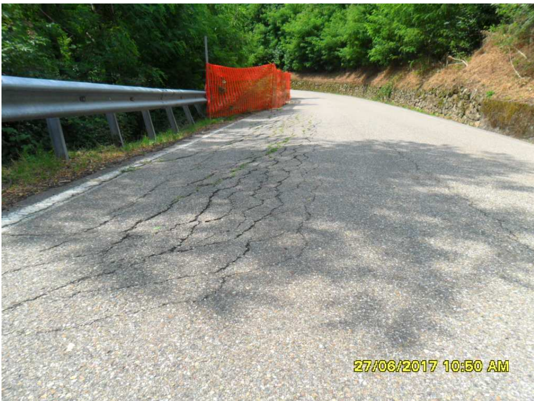
Foto 4: particolare cedimento piano viabile (punto di ripresa dir. Casapinta)
