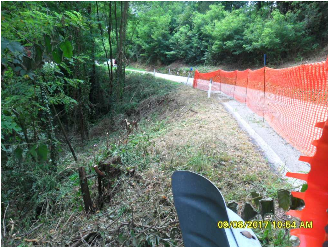
Foto 1: particolare cedimento (punto di ripresa dir. Casapinta)
