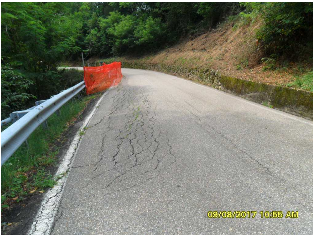
Foto 2: particolare cedimento piano viabile (punto di ripresa dir. Casapinta)
