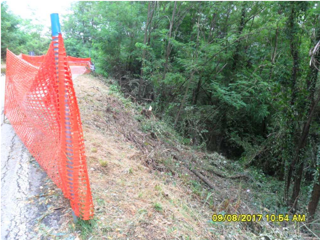
Foto 3: : particolare cedimento (punto di ripresa dir. Trivero)
